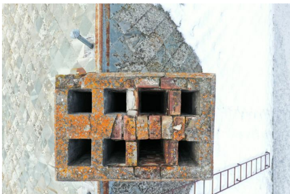
Skorsteiner med 8 kanaler
