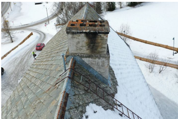
Takstige bør byttes, og festes til taket.
