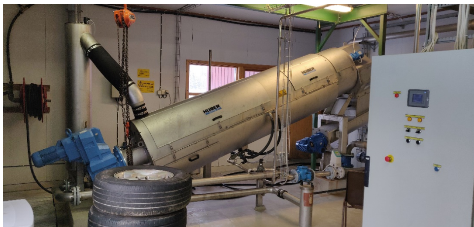
Figur 26 Tolga avløpsrenseanlegg, prosessbilde
