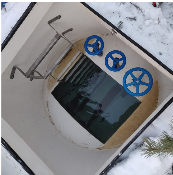
Figur 11 Helgesbekken vannverk, Brønn
