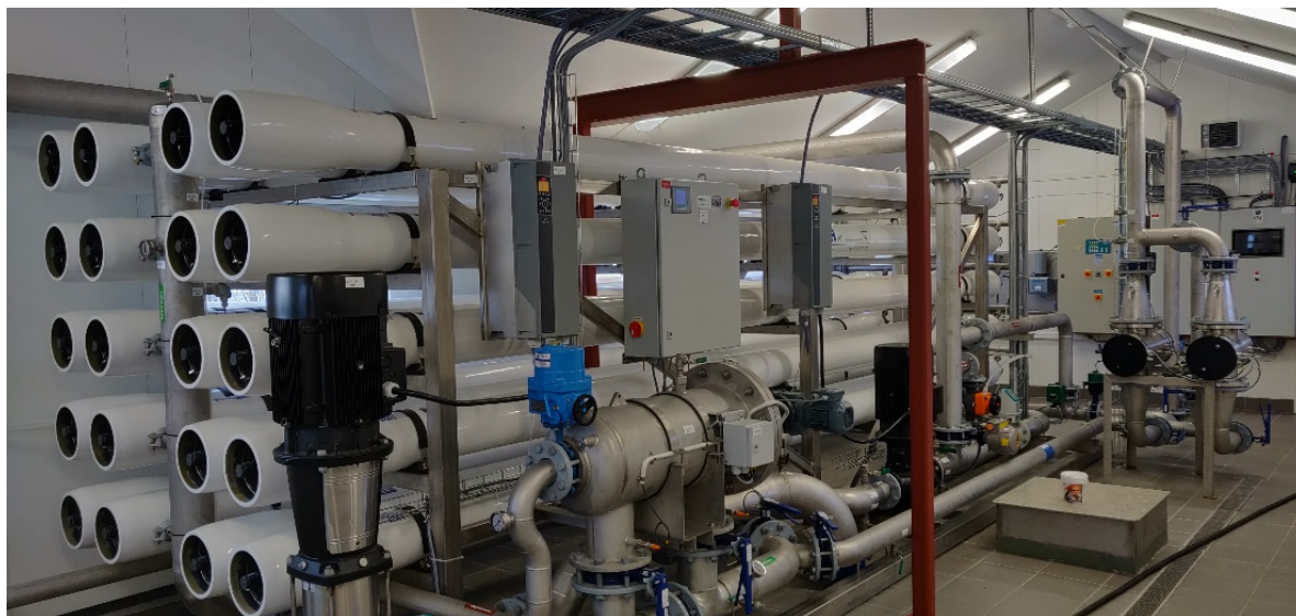
Figur 24 Tolga vannbehandlingsanlegg, prosessbilde fra produksjonshallen. Membranene til venstre og UV-anlegget til høyre lenger bak i rommet.
