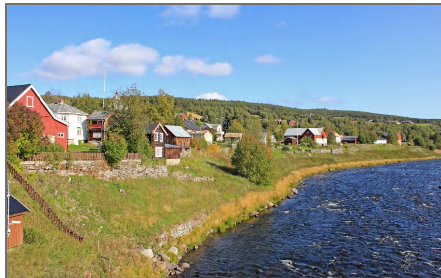
Figur 8.8: Murene langs Glåma ved Gata (Hyttgata) kommer godt til syne på våren. Lenger ut på sommeren er murene nesten ikke synlige pga gjengroing med vegetasjon. Flere murer er i kritisk tilstand. Enkelte har allerede rast ut, og kommer derfor ikke fram på bildet. Foto vår 2020: Anja Ø. Ryen
